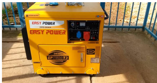
Figure 4 : Groupe électrogène antenne de Makamba
